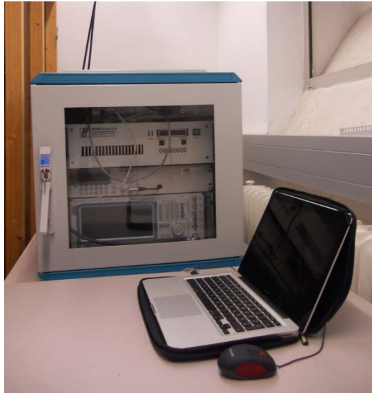
Abbildung 3.3: Aufbau der Signalgenerierungs- und Verstärkungseinheit, untergebracht in einem 19 Zoll Rack (Hintergrund) und Laptop Computer mit Steuer- und Aufzeichnungssoftware (Vordergrund), installiert am Institut für Umwelthygiene, Kinderspitalgasse, 1090 Wien.
